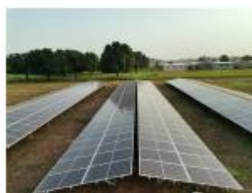
Mali: Ländliche Elektrifizierung
